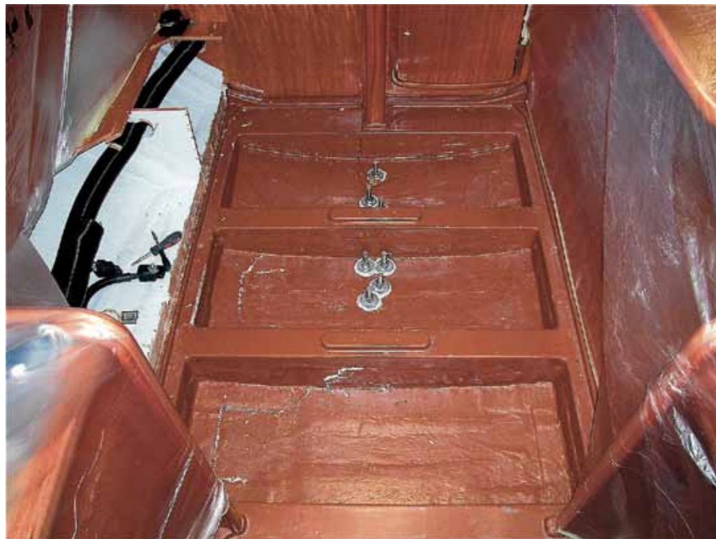
Bavaria 32 -02 Fart ca. 3 till 4 knop. En typisk snedträff på kölen från styrbord har skapat stora skador på babords botten och babords kojfront. Borrprover i balkar och i botten visade på så obegripligt låga värden som mellan 5 och 6 mm tjock laminat.
