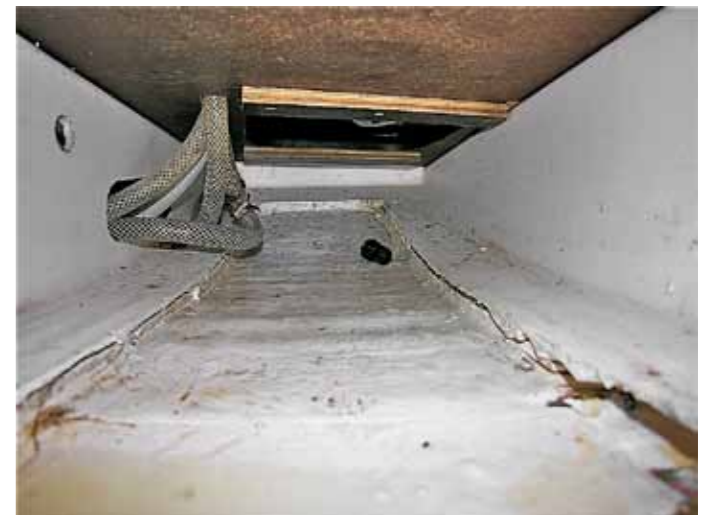
Bilden visar det helt loss-slitna basinredet från skrovet och de tre slangarna är för varmt och kallt sötvatten plus sjövattnet upp till pentryt ovanför.
